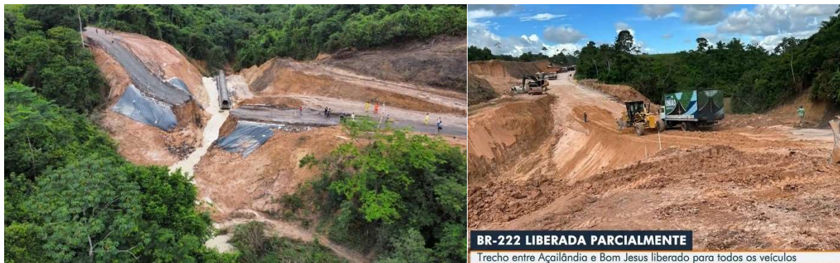
Figura 5: Registro de imagens das consequências causadas após a reabertura de cratera no trecho do Rodovia BR-222 em 24/04/2024. Fonte: Portal G1.
