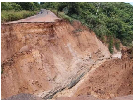
Figura 4 – Imagens fotográficas das consequências causadas após a abertura de cratera no trecho da Rodovia BR-222 no km 594 e alagamento próximo a Estrada de Ferro Carajás. Fonte: Portal G1.
